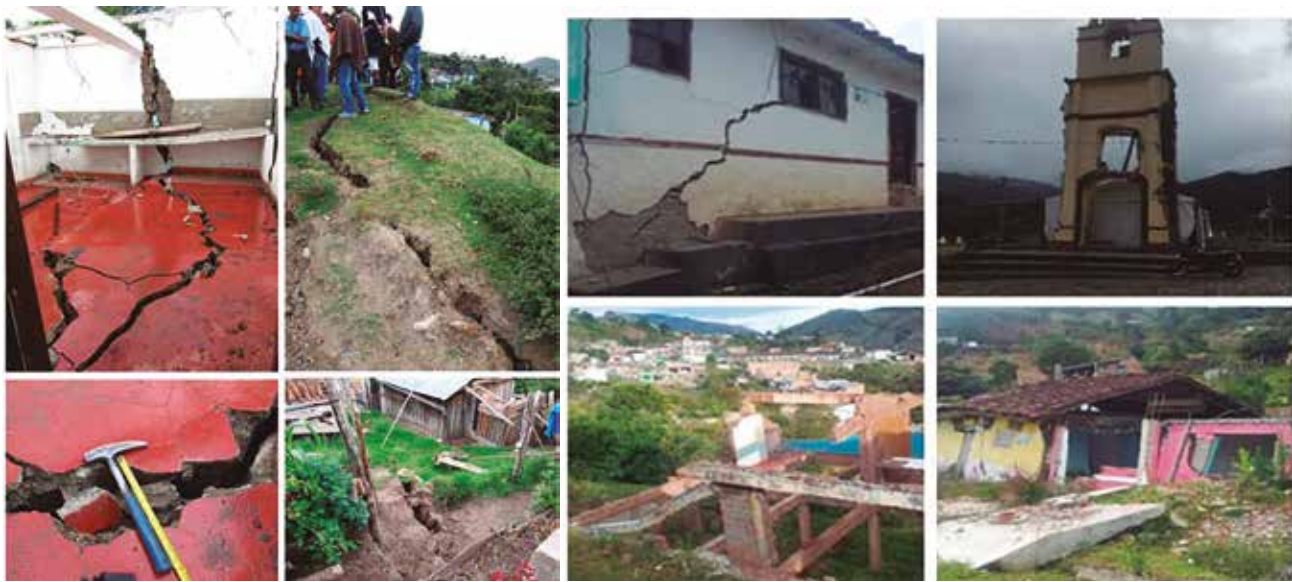
Figura 22. Estado de las edificaciones y del territorio del resguardo por afectación de la falla geológica 42
