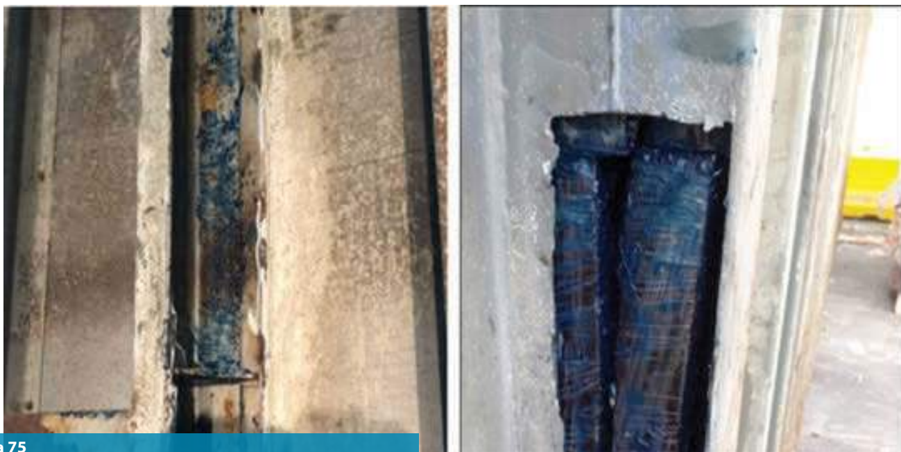
Figura 75 Contaminación en estructura de un contenedor (vértices).
